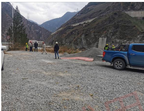
主变压器组装场（2024 年 8 月）
