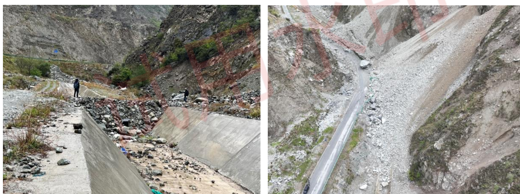
图 9.2.5 排洪渠多处段落堵塞现状
